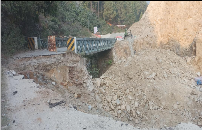
बैसे-भीमफेदी सडक १०० मिटर फराकिलो बनाउने योजनाअन्तर्गत भीमफेदी बजार नजिक कुलेखानी जन्मियुत आयोजनाको सुरङसरीको रहेको मोटेरबल पुल । बैसे-भीमफेदी सडक निर्माणको क्रममा घोपफेदी पुल निर्माणको लागि खनिएको जंगको कारण कुनै पनि यातायातको साधन ओहरोहोरो गर्न पाएका छैनन् । वैकल्पिक मार्ग घोपफेदीबाट घुन्टु खोला हुँदै खोलीसम्म जीर्ण कच्ची सडकबाट सवारीसाधन ओहरोहोरो गरिरहनु परेको छ । वैकल्पिक बाटोको स्तरीकरण नगरी खोलाको बगरबाटै अस्थायी रूपमा सवारीसाधन गुड्दा यात्रुहरूले सक्ती भोग्नु परेको छ । पुलबाट सवारीसाधन चल्न करिब ५ महिना लाग्ने हुँदा वैकल्पिक मार्गलाई स्तरीकरण गर्नुपर्ने आवाज स्थानीयहरूले उठाएका छन् । तस्वीर सौजन्य: सुरेन्द्र राज विके ।
